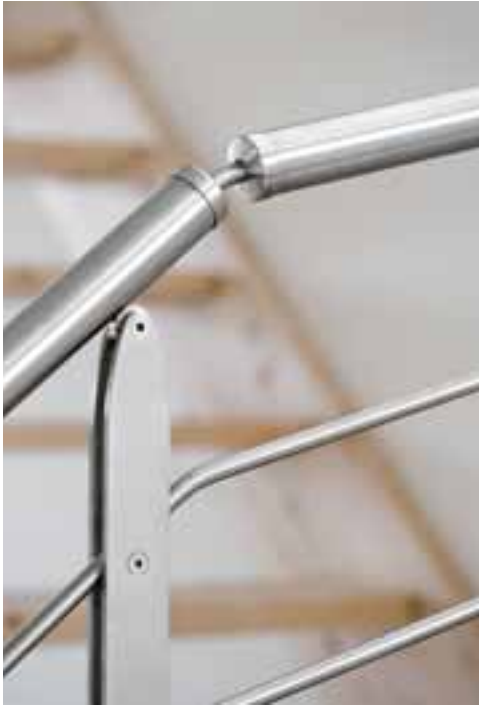
Raccordo del cambio di pendenza sulla ringhiera lato esterno.
